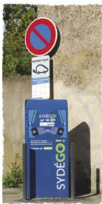
Borne installée rue de l'Océan et prochainement rue Saint-Pierre.
